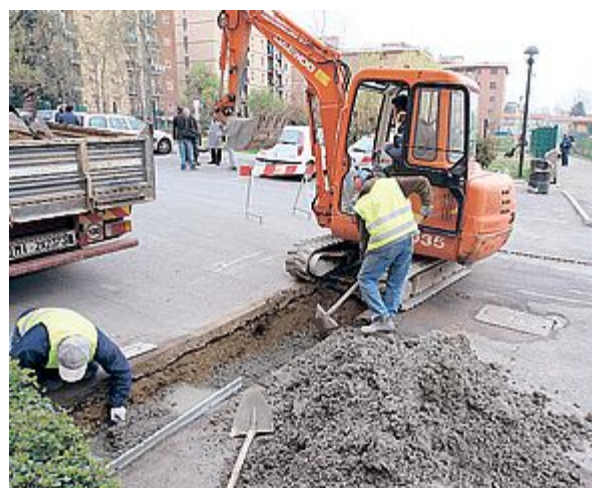
RUSPE Uno dei numerosi cantieri stradali di Monza che creano disagi alla viabilità (Rossi)
